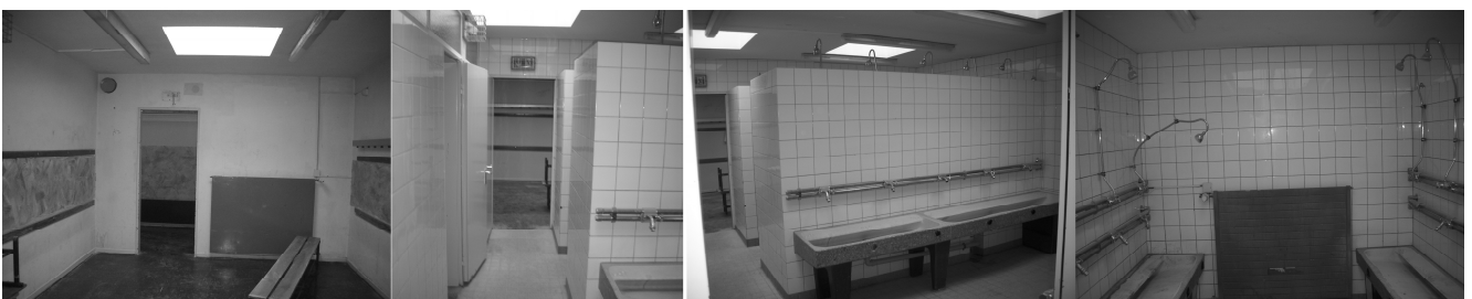
Zustand des Dusch- und Umkleibereiches vor der Sanierung
