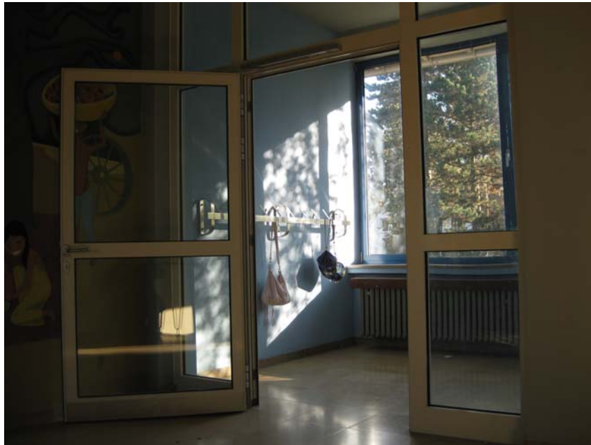
"Garderobennische" mit T30-Tür als Feststellanlage
