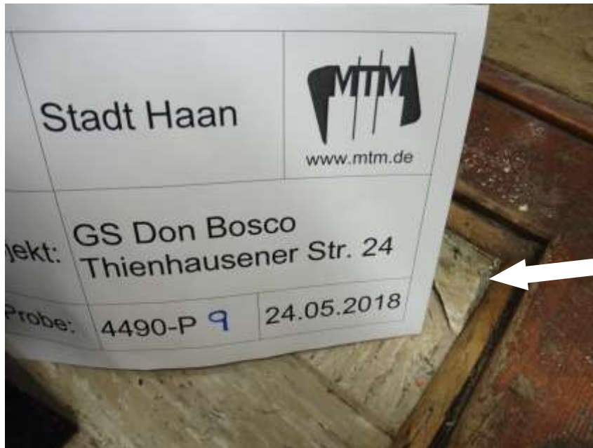
Probe-Nr. 4490-P9 Kleber unter PVC-Bodenbelag, Räum 102 und 106, OG
