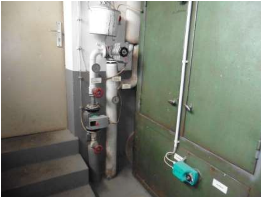
Mögliche asbesthaltige Flanschdichtungen in der technischen Gebäudeausrüstung, EG, Turnhalle
