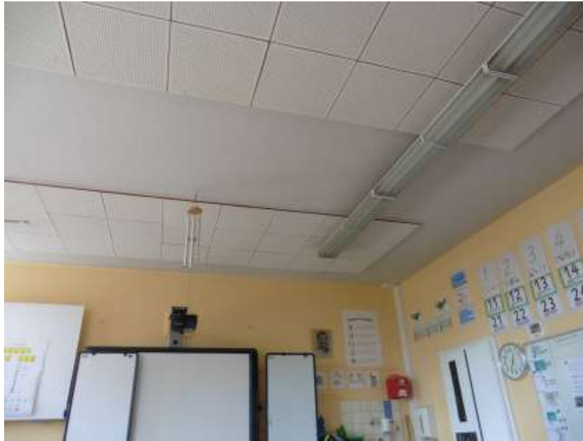
KMF-Platten als Deckenverkleidung
