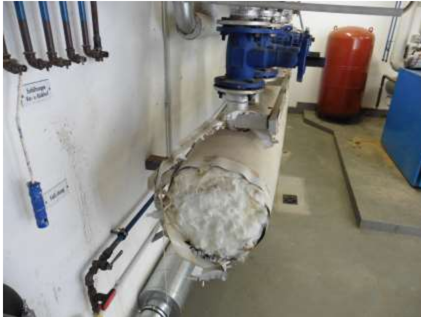
Künstliche Mineralfasern als Isolierung der technischen Gebäudeausrüstung
