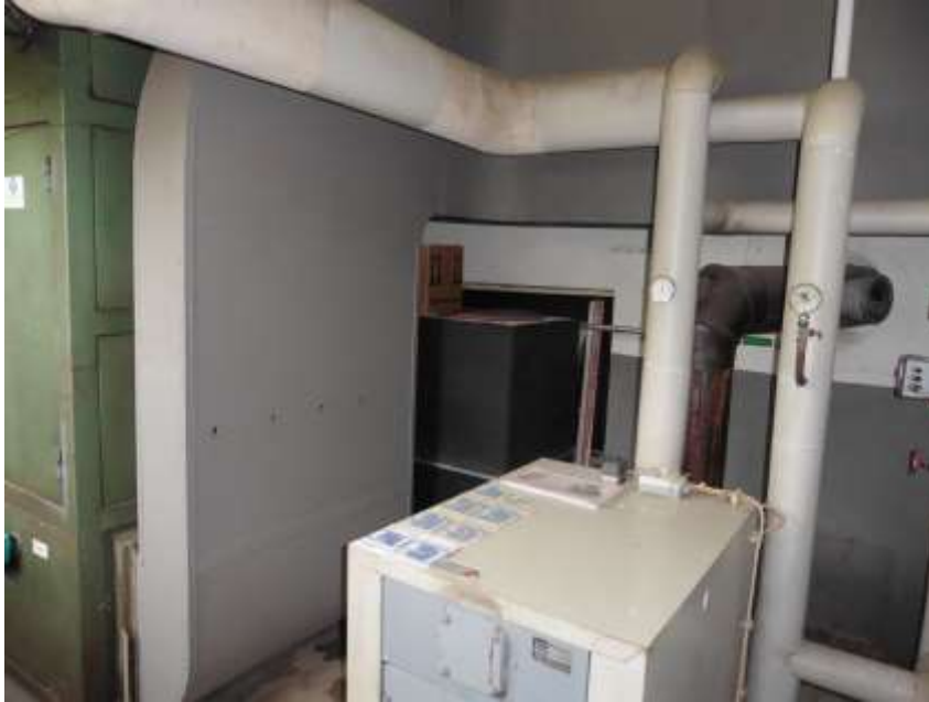
Asbestplatten als Lüftungskanal und KMF-Isolierung von Rohrleitungen, EG, Turnhalle
