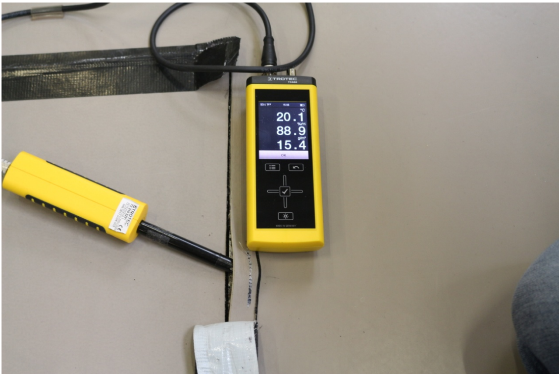
Bild 5: mit fast 90% deutlich erhöhte Feuchtigkeit am Rand des Einstickkastens
