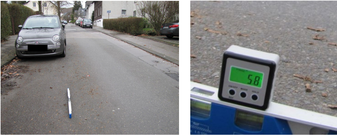
Bild 5: Fahrbahneigung im südlichen Straßenabschnitt der Turnstraße
